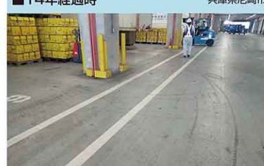
2020年撮影 【構造】S造 【工法】ポリルーフPP-2VS工法 【施工】2006年12月【面積】9,000㎡
