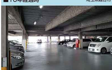
2016年撮影 【構造】S造 【工法】ポリルーフPP-1V工法 【施工】2001年11月【面積】4,000㎡
