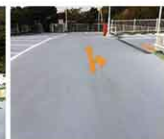
【剥がれ・浮き等確認】
