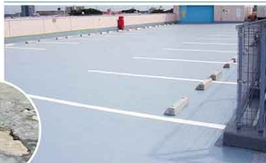
◀既設塗膜防水の剥離
