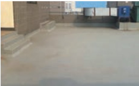
某工場 屋上(中国／常州市)
