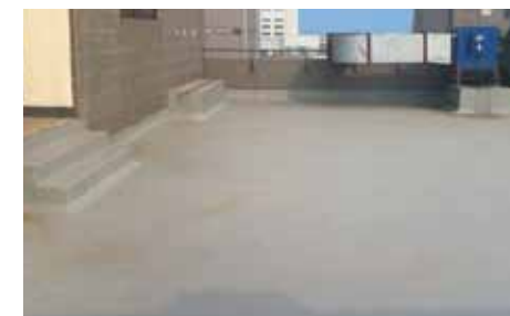
某工場 屋上(中国/常州市)
